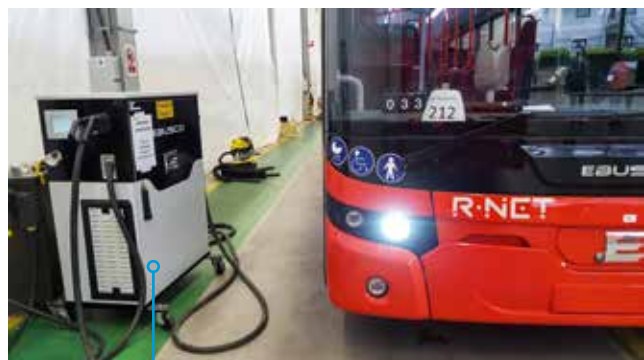
Les nouvelles bornes de charge permettent de brancher simultanément deux bus.
